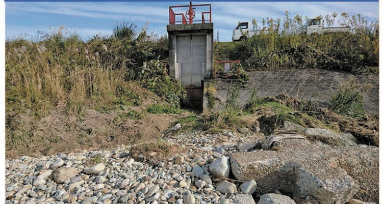
2017年11月16日 危険個所の調査 (台風21号大雨での土砂堆積)
